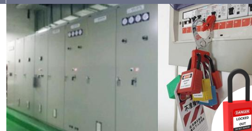
수배전반 전원 작업 LOTO
